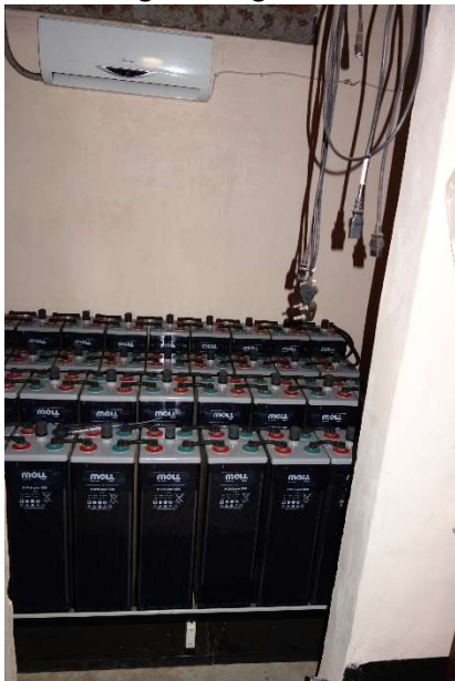
Batterien der Solaranlage
